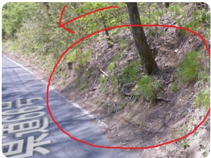
8年前の状態。すでに枯れて危険な状態であることがわかる。
