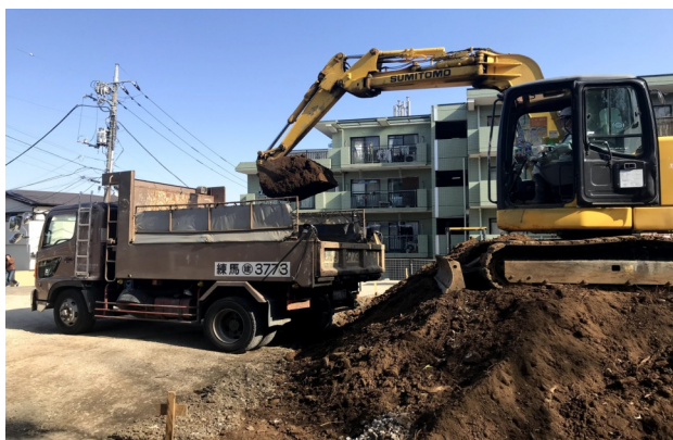
都内の建設現場から搬出される発生土。その多くがストックヤードに搬入されます。
